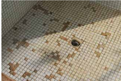
Boden einer Dusche beim Hotelschwimmbecken
