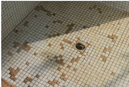
Boden einer Dusche beim Hotelschwimmbecken
